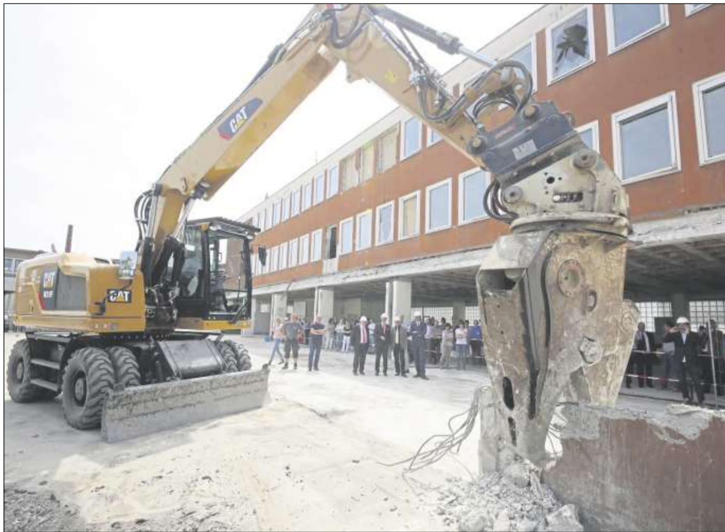
Der Baustart auf dem ehemaligen Postgelände könnte für Landrat Johannes Fuchs schon die letzte Gelegenheit gewesen sein, sein Talent als Baggerführer unter Beweis zu stellen. Wobei die Bisse, die der von Fuchs gesteuerte Bagger aus dem Mauerwerk gerissen hat, eher Häppchen waren. Bilder: Habermann
